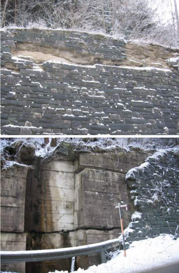
Abbildung 2 Schäden an Stützwänden der existierenden „alten“ Trasse
