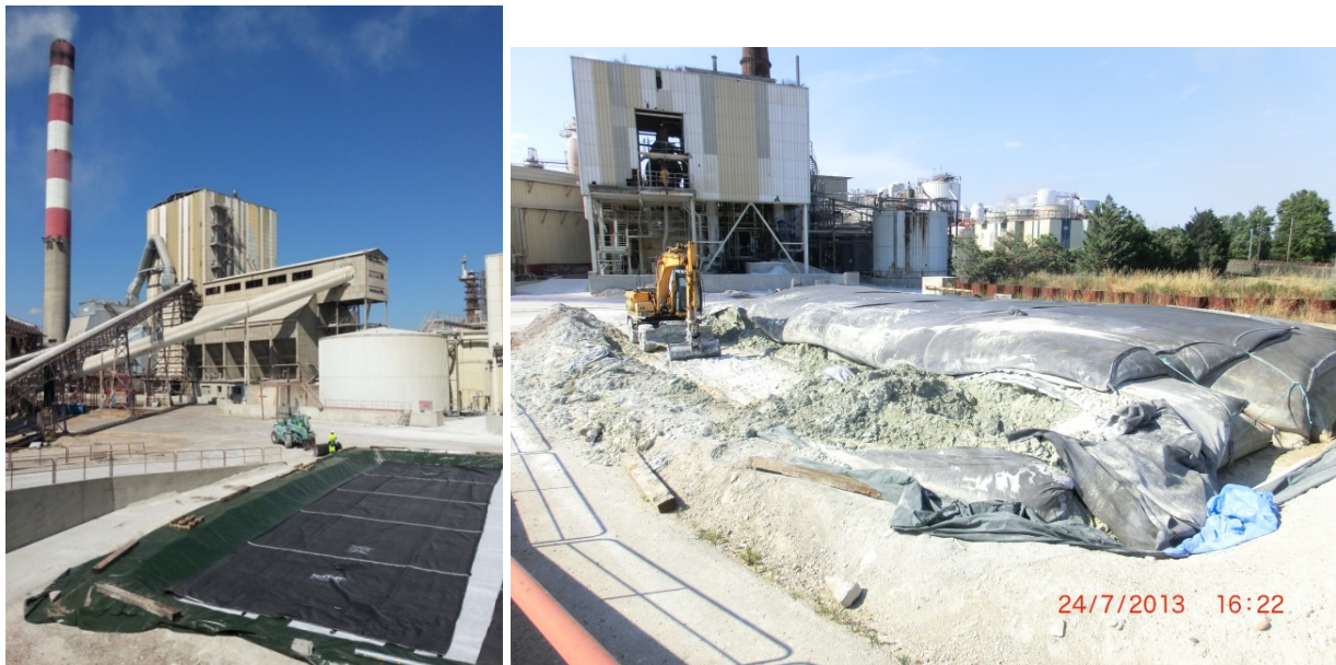
Figure 8 : Plate-forme d'essorage des boues à proximité immédiate de l'usine avant remplissage (à gauche) et extraction des boues déshydratées (à droite)
